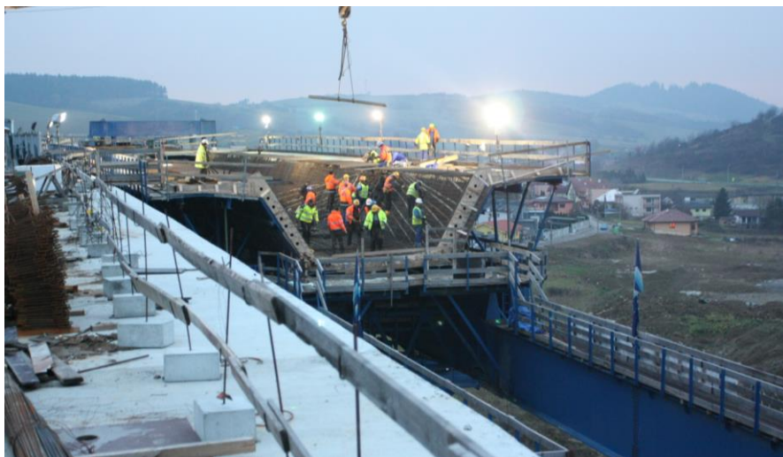
Obr. 103 Pohľad na debnenie čela segmentu komorového prierezu. Výsuvná skruž s dolným trámom (Hričovské podhradie – Lietavská Lúčka, 2015).
