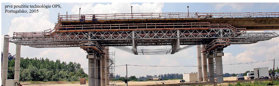
Obr. 107 Skruž so systémom OPS – prvá aplikácia. Most ponad rieku Rio Sousa, Portugalsko, 2005 [5].
