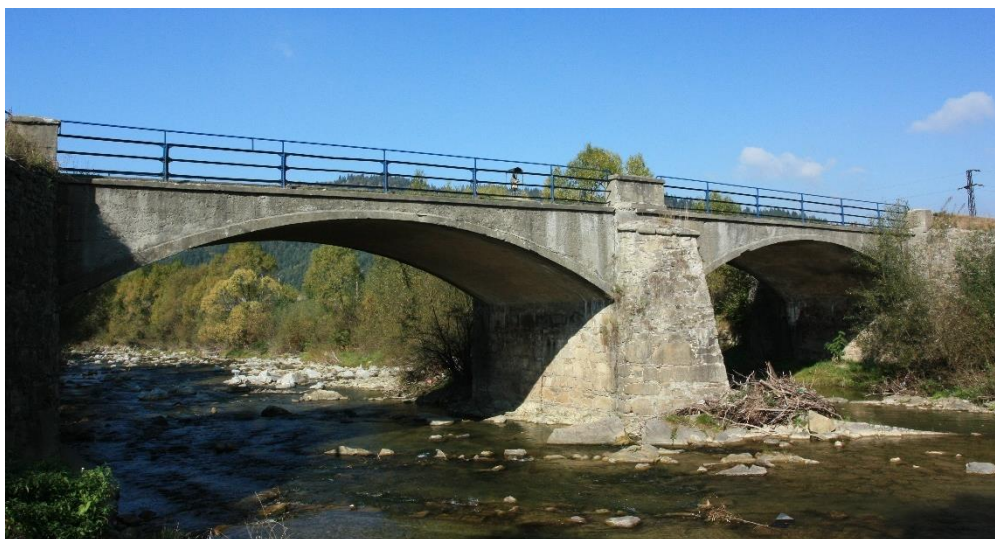
Obr. 1 Najstarší zachovaný železobetónový most na Slovensku z roku 1891 v Krásne nad Kysucou (fotka z roku 2011, pred rekonštrukciou mosta, po viac ako 120 rokoch prevádzky).
