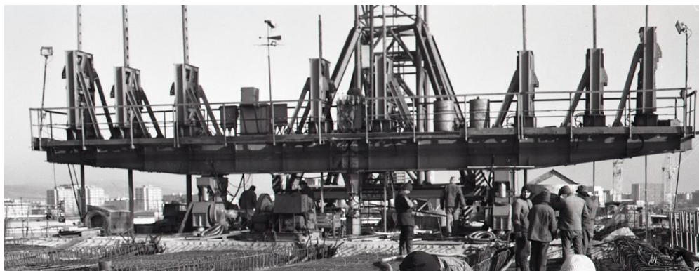
Obr. 98 Zadný priečny rám položený na konzole už hotovej časti mosta, na ktorom sú podvesené hlavné trámy skruže. Rám zároveň slúži aj ako vozík na presun skruže (TASR)
