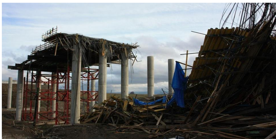
Obr. 49 Pohľad na skruž po zrútení v 2. poli (2012).
