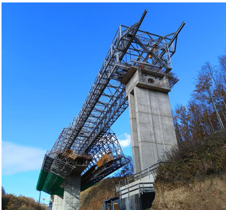
Obr. 67 Dĺžka výsuvného nosa skruže umožňuje uloženie podpery už počas prác na predošlom betonážnom zábere (R2 Kriváň – Mýtňa, 2023).
