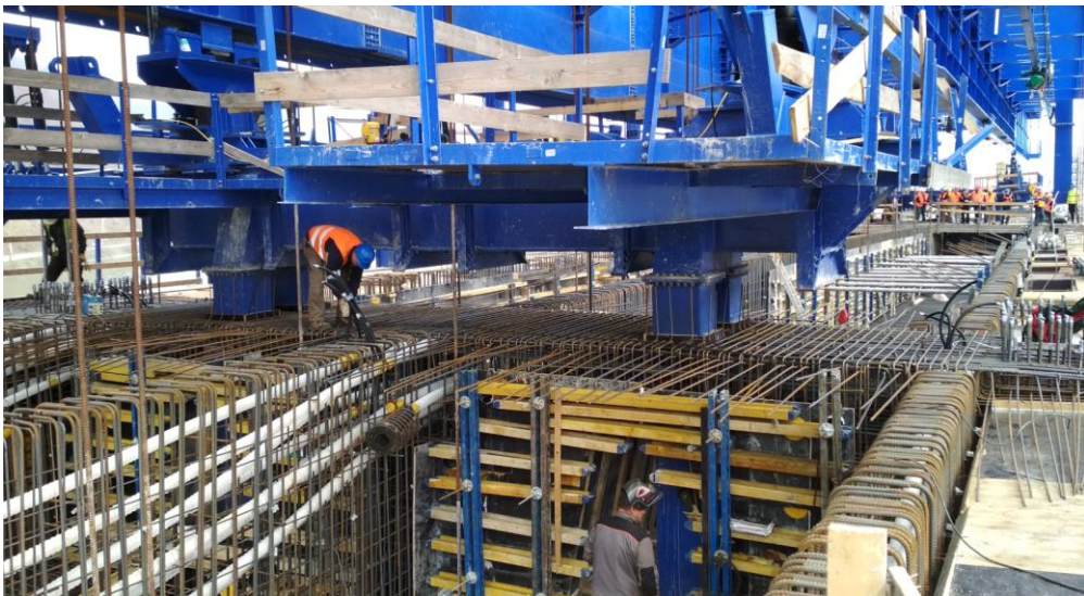
Obr. 72 Oceľové podpery výsuvnej skruže umiestnené na piliere – fáza zadebného a vyarmovaného priečnika (výstavba železničného mosta ponad Nosickú priehradu, 2018).
